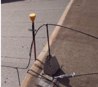
2. sz. kép: Villámhárító a tetőn [11]
